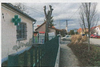
Schátrať bývalú budovu obecného úradu v centre obce treba čím skôr obnoviť.
